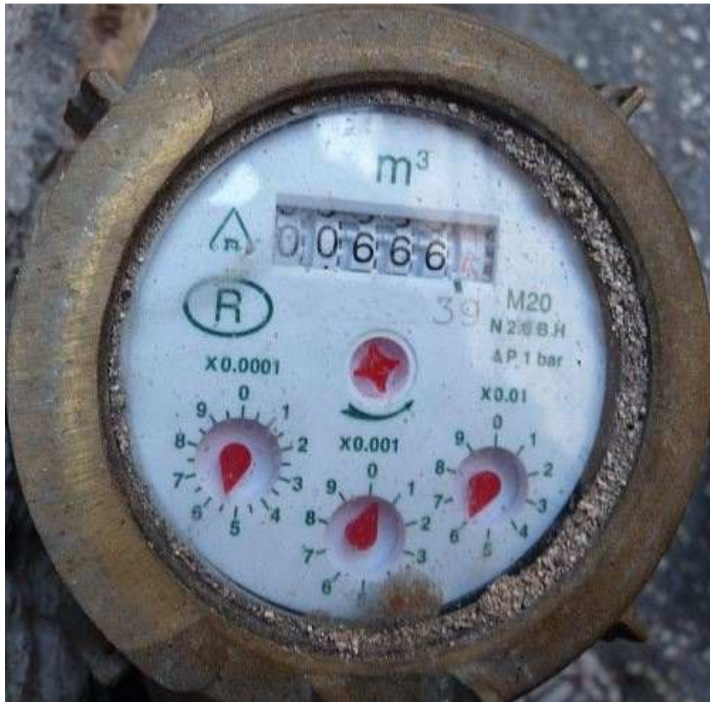
Compteur à eau dans une rue de Jérusalem
