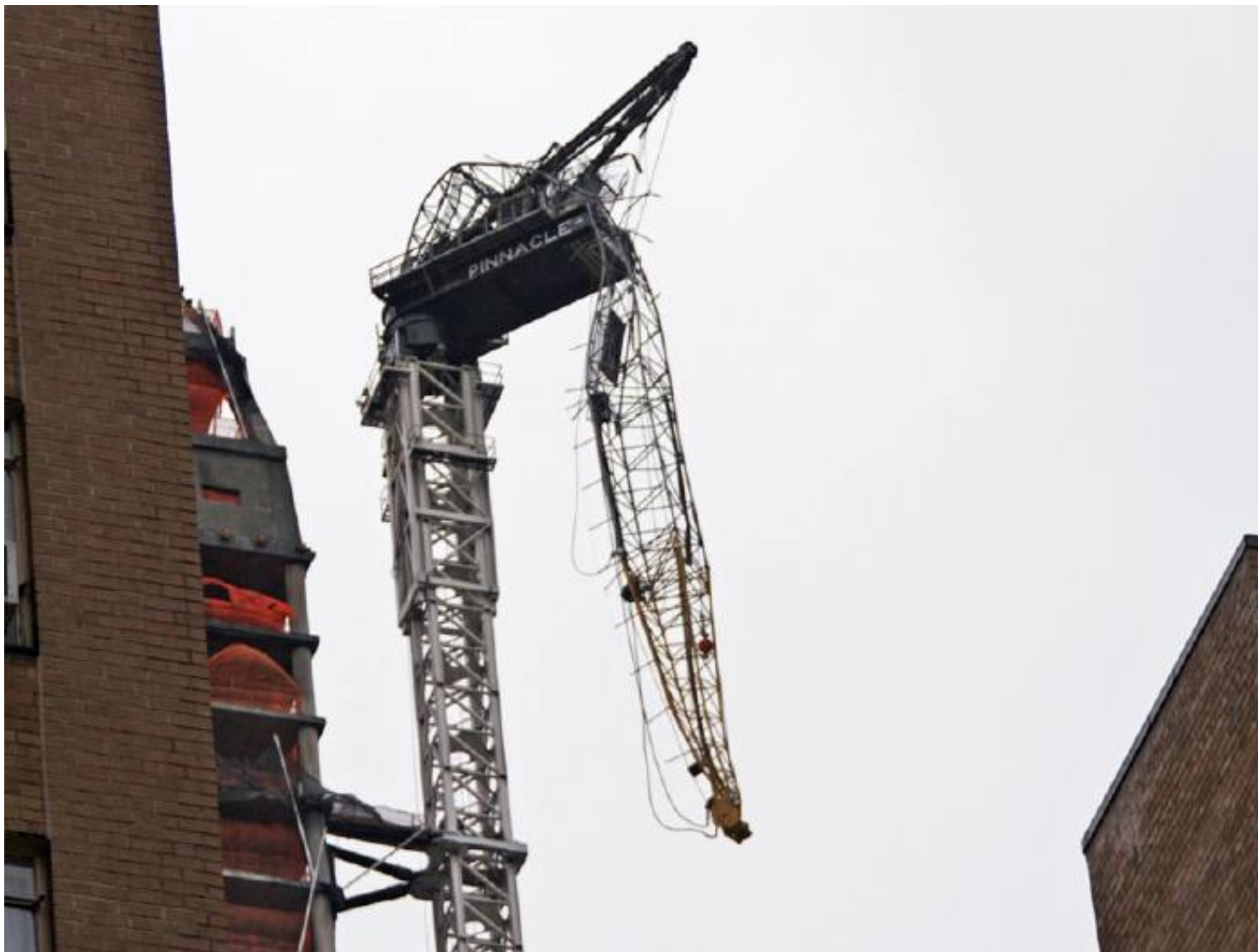
grue endommagée accolée à la tour One57
