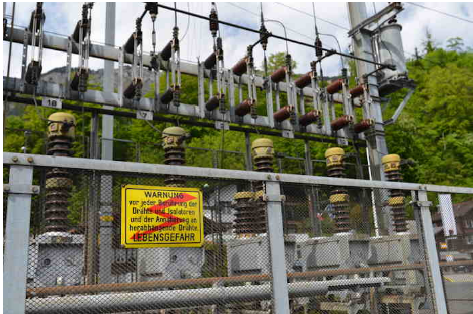
— Transformateur en gare de Brienz — Brienz —
